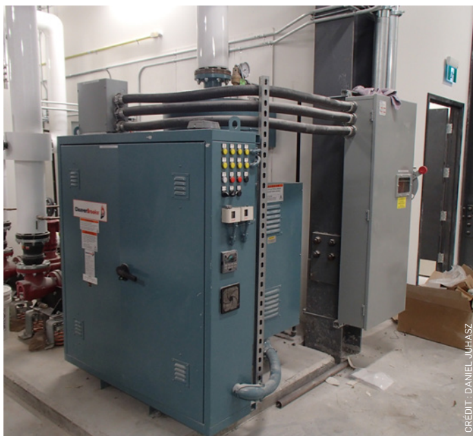
Une seule chaudière électrique sert au chauffage du bâtiment. Elle est assistée d'un système de chauffage radiant au glycol dans le plancher du rez-de-chaussée.
