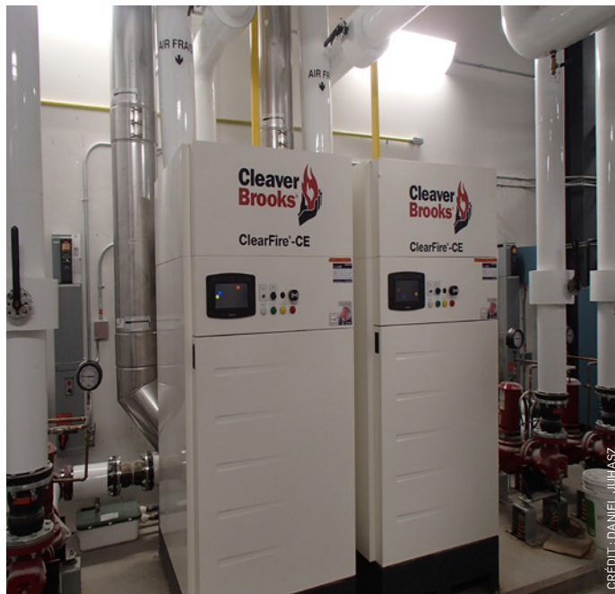
Deux chaudières au gaz naturel sont utilisées en appoint aux heures de pointe et pour prendre le relais lors de la maintenance de la chaudière électrique.
