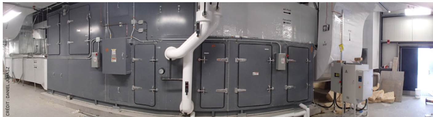
Le système de ventilation des bureaux est relié à deux échangeurs récupérateurs de chaleur à cassette très performants.
