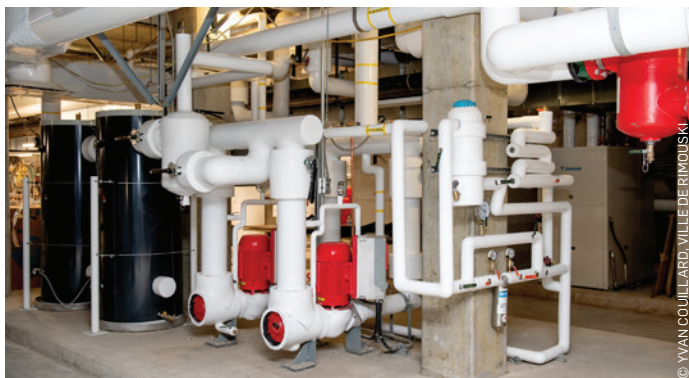
Pompes et refroidisseurs
