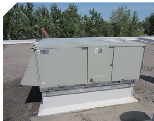
Les unités de toit sont courantes dans les petits bâtiments.
