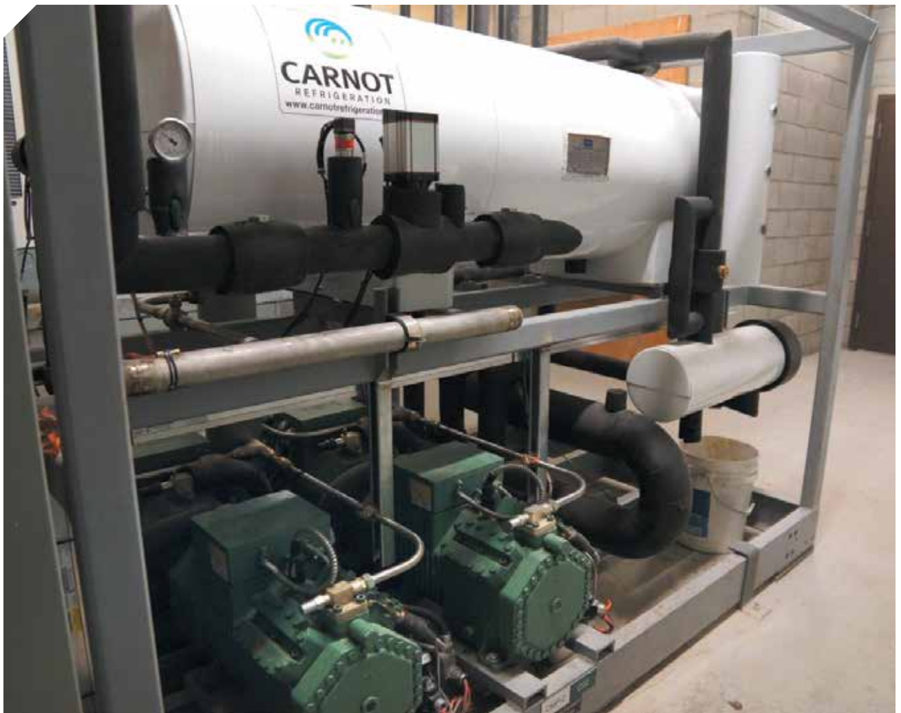
Système de climatisation au CO 2 Transcritique à expansion direct.
