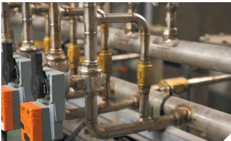
Portion du récupérateur de chaleur provenant du système de réfrigération.
