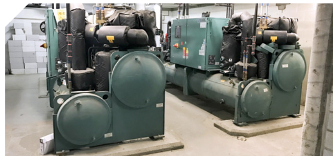
Nouvelles thermopompes permettant la récupération de la chaleur au sous-sol du centre sportif
