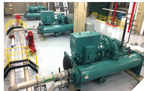
Nouveaux refroidisseurs install  s dans la centrale thermique
