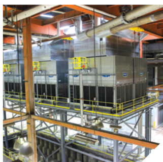
Nouvelles tours d'eau
