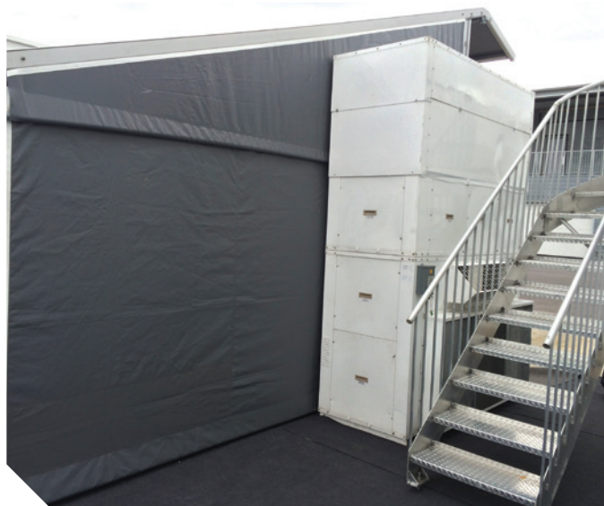
Climatisation monobloc verticale 12 tonnes à chacune des loges hospitalités des pilotes
