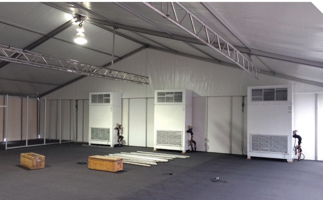
Climatisation de la tente m  dia (3 Fan coil reli  s    un chiller ext  rieur)
