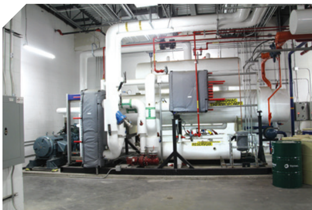
La thermopompe de 200 tonnes à l'ammoniac fournit environ 1 000 kW pour le chauffage de l'eau. Elle possède son propre circuit.
