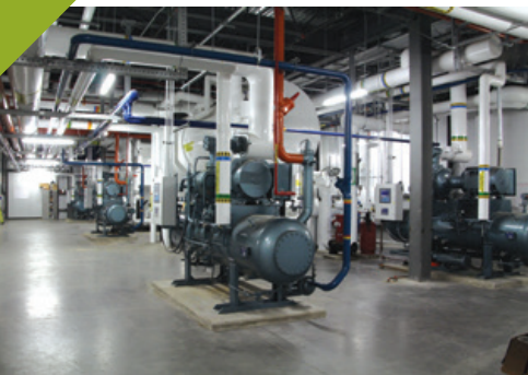
Les compresseurs à l'ammoniac des centrales d'air.
