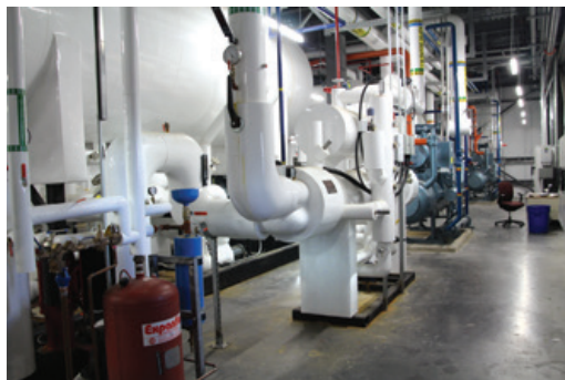
La salle mécanique : le refroidisseur pour la climatisation des bureaux.
