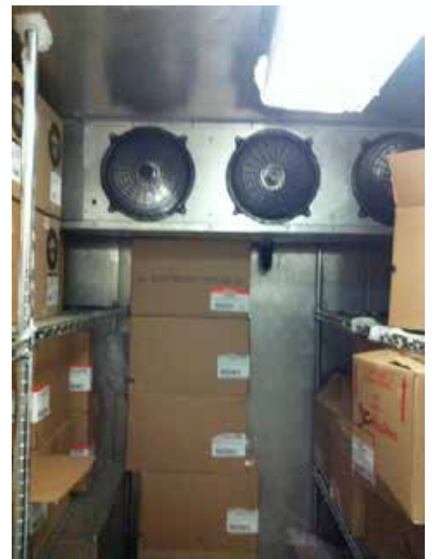
Figure 8 - Absence de givre sur les surfaces
