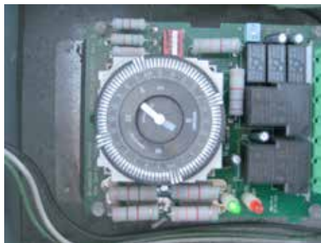
Figure 3 - 4 périodes fixes de dégivrage de 45 minutes
