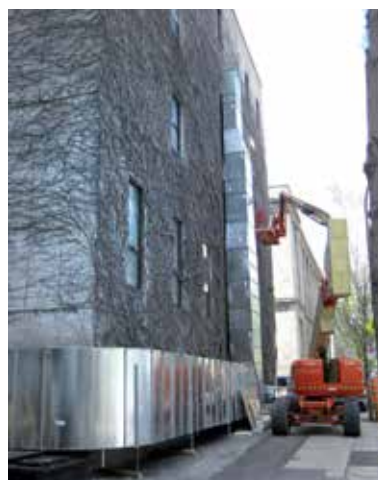
Les conduits temporaires longent les murs et pénètrent par les fenêtres pour parvenir aux réseaux en exploitation.
