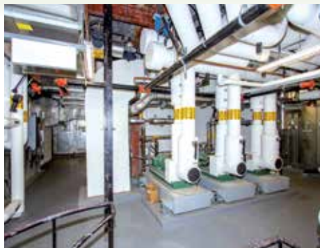
Les salles mécaniques
