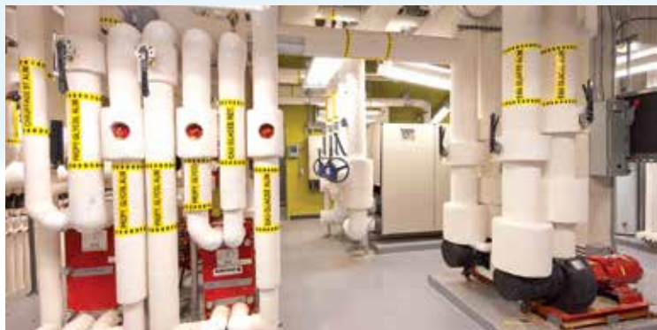
Salle mécanique : les échangeurs en chauffage et en refroidissement
