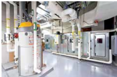
Salle mécanique : l'unité d'air neuf.
