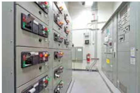
Cette salle électrique est refroidie par un climatiseur dont la chaleur est récupérée.
