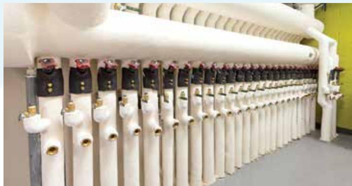
Collecteur des puits géothermiques
