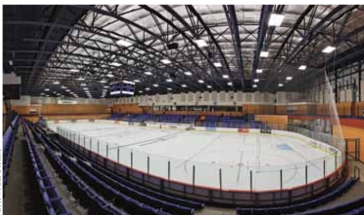
Le chauffage radiant des gradins procure du confort aux spectateurs sans nuire à la qualité de la glace.
