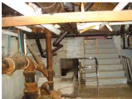
État déplorable du sous-sol et de la plomberie
