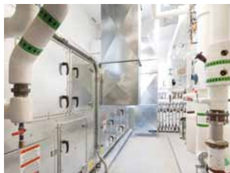
Une partie de la salle mécanique
