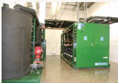
Le cœur du système : la centrale de réfrigération (Systèmes LMP). À gauche, le réservoir de coulis de glace et la station de pompage.
