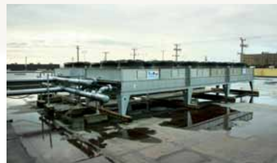
Le refroidisseur de liquide (Refrplus) branché sur une boucle secondaire au glycol.
