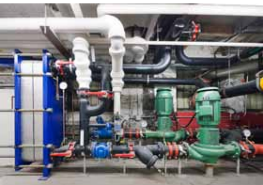
Salle mécanique principale au sous-sol
