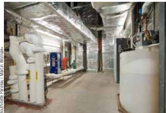
Salle mécanique typique d'étage
