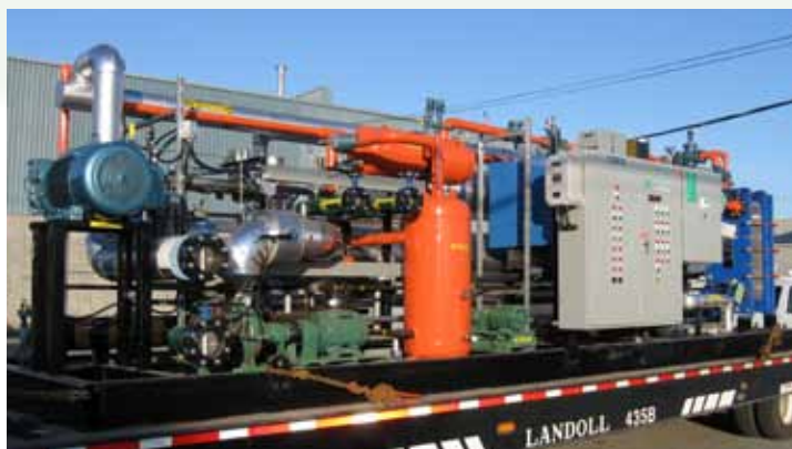
Le système de réfrigération à l'ammoniac de l'aréna de Saint-Canut dans les Basses-Laurentides.
