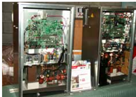
Deux modules City Multi de Mitsubishi Electric pour le chauffage de l'eau.
