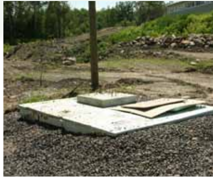
Réservoir de stockage
