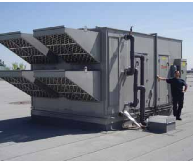
L'air neuf est climatisé directement dans les nouvelles centrales d'air qui remplacent les unités de compensation d'air.
